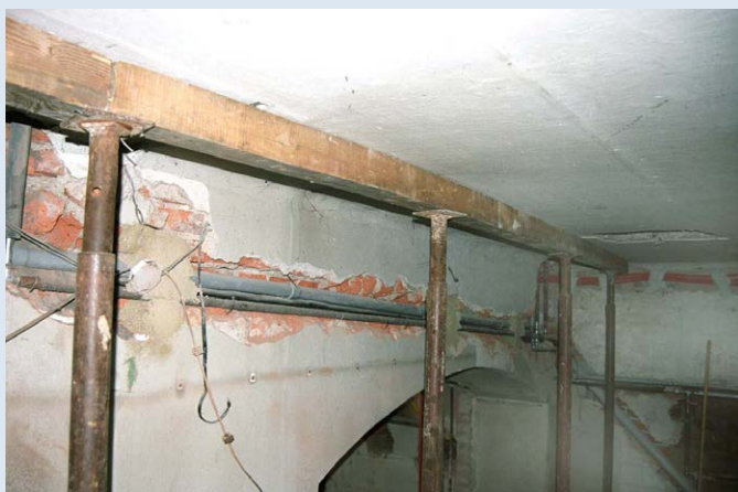
Slika 4: Nedovoljena izvedba utorov v ločnem nosilcu.
