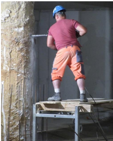
Slika 9: Neustrezno urejeno delovno mesto – improviziranje na gradbišču
