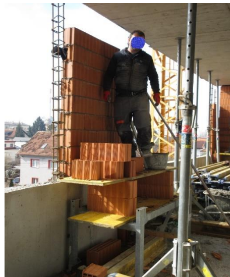
Slika 10: Neustrezno urejeno delovno mesto – improviziranje na gradbišču
